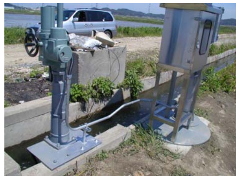
(b) 태양광 전동수문 구동부 및 제어반
