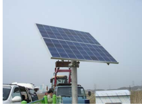
(d) Solar Unit
