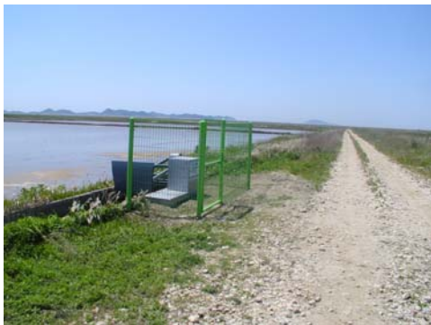
(c) 무동력 자동수문 전경
