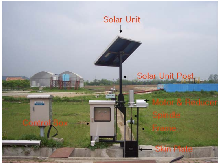
사진 3.1.1.1 현장에 설치된 태양광 전동 수문
