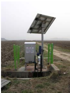
(a) 태양광 전동수문 설치 전경
