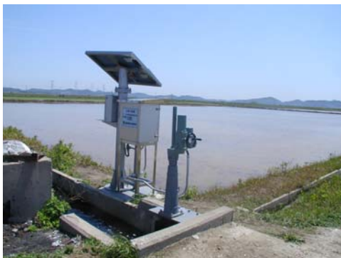
(a) 태양광 전동수문 전경
