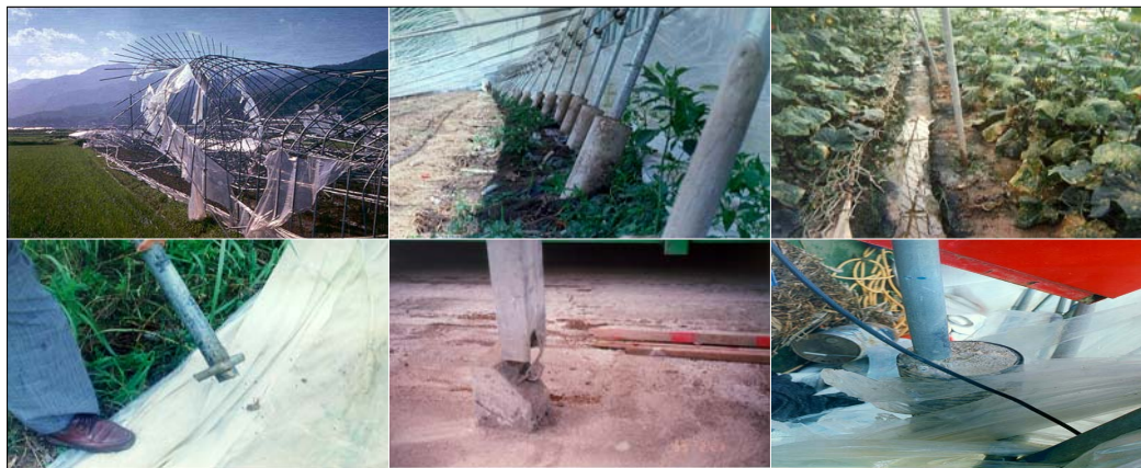
그림 7. 강풍에 의한 온실의 기초 파손
