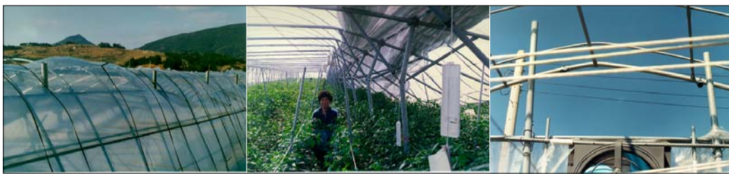
그림 12. 강풍에 의한 온실의 접합부 파손
