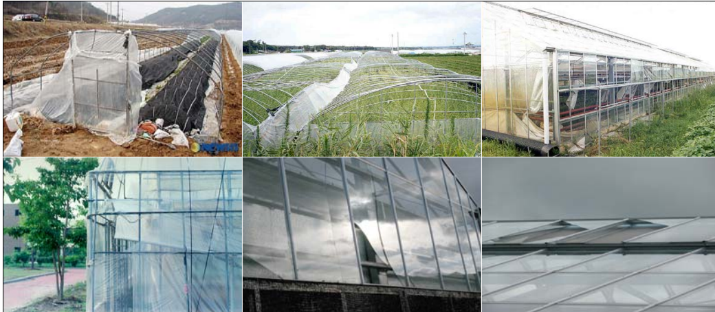
그림 8. 강풍에 의한 온실의 피복재 파손
