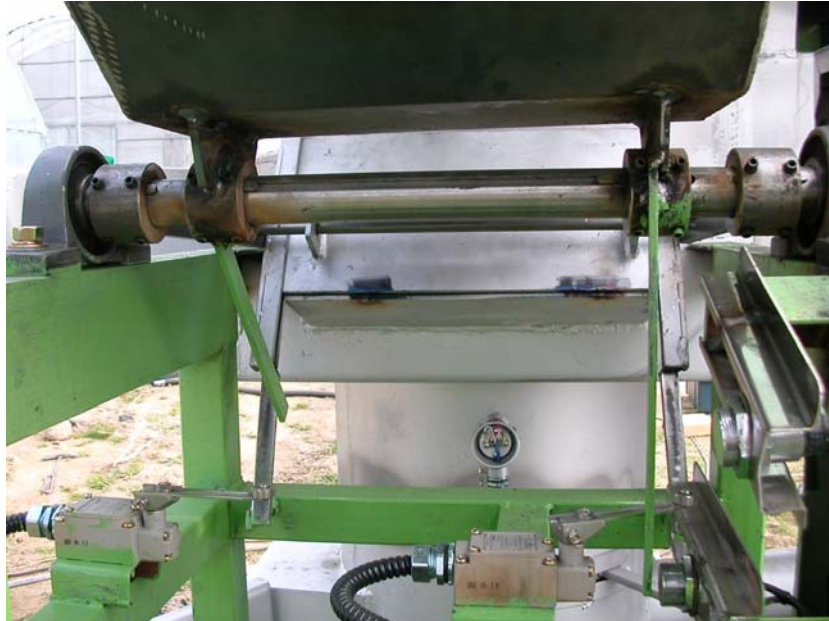
그림 57 석탄공급 호퍼의 구동축 및 제어용 센서와 스위치
