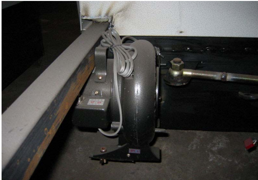
그림 20 연소공기 공급부의 송풍기
