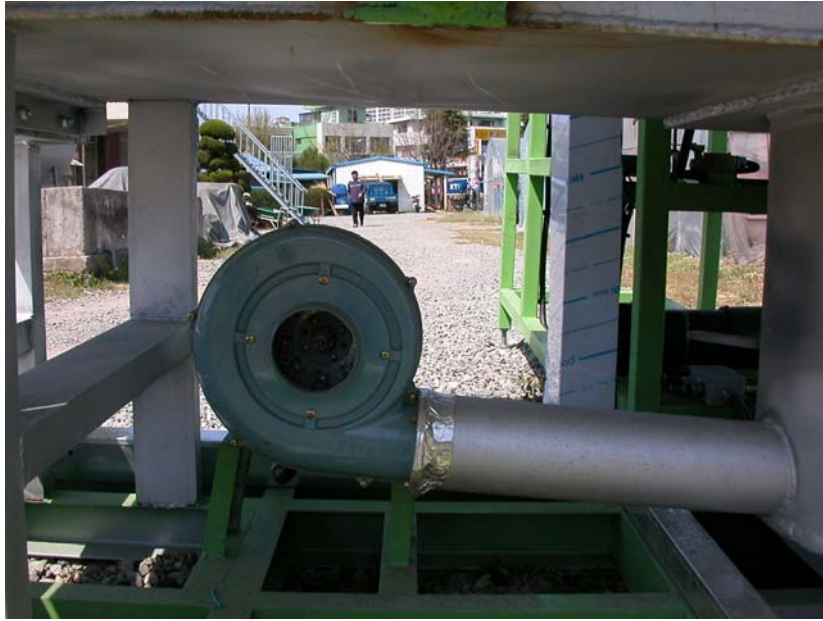
그림 50 연소공기 공급용 송풍기
