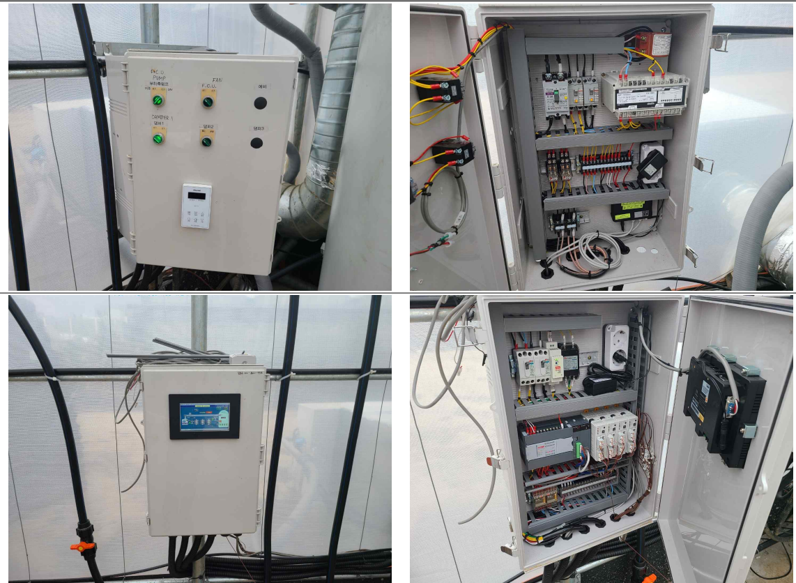
[ 농축산가온시설용 에너지절감형 난방장치 자동제어반 설치 및 적용 ]
