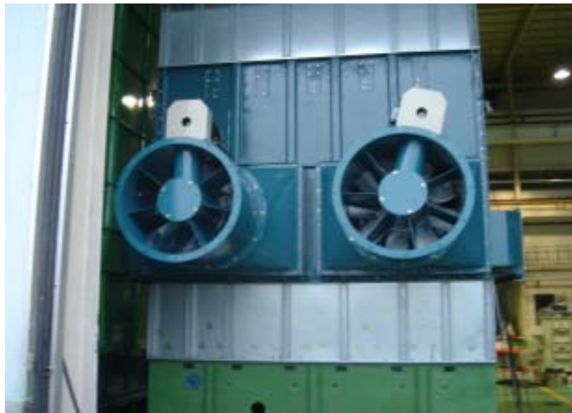
(c) Air outlet fan
