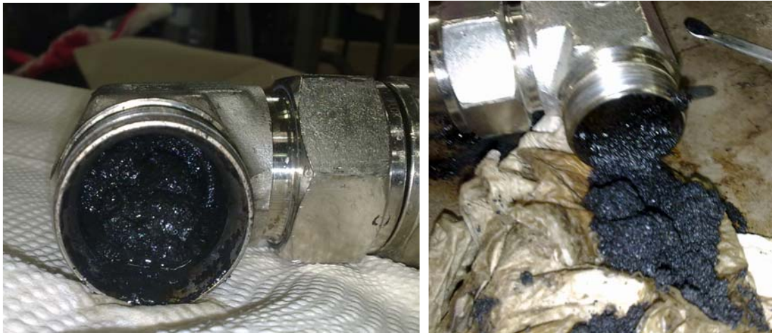
그림 3-42. 돈분을 이용한 관형 열수분해 반응기 2차운전시 배출 밸브 막힘 현상 사진
