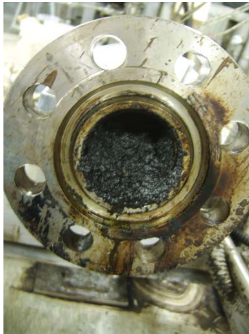
그림 3-39. 돈분을 이용한 관형 열수분해 반응기의 1차운전시 발생한 반응기 내부 막힘 현상 사진
