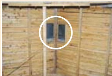
저장고 내 천정 배기구
