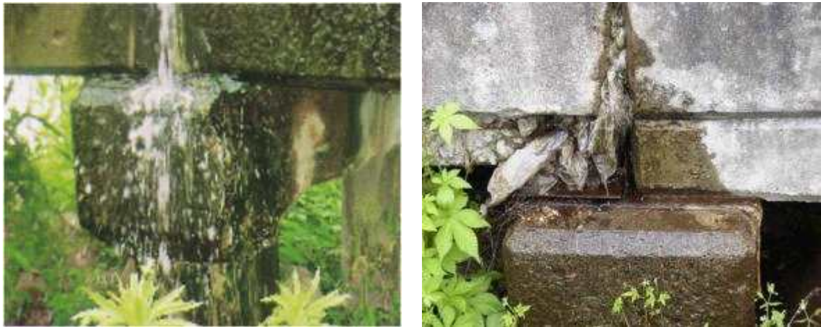
사진 3.1 수로교의 이음부 파손
