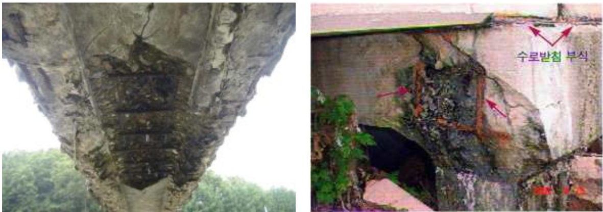
사진 3.6 수로교의 철근 부식
