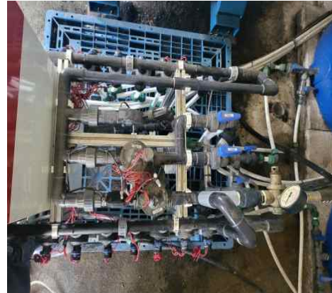
드라이포그 펌프 배관
