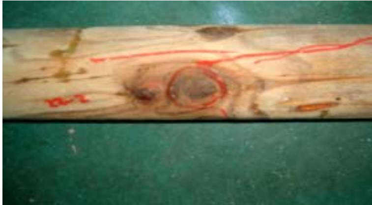
그림 3-8-25. 방부 처리 원주목의 파괴형상(LC-4)
