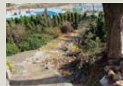
배수로 미설치에 따른 우수유입(계동리 산7-8일원)
