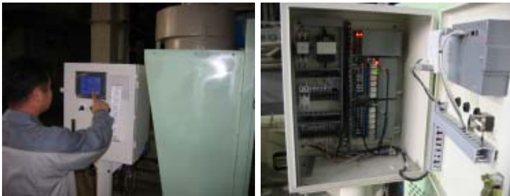
그림 35. 정선지수측정시스템의 컨트롤러 사진
