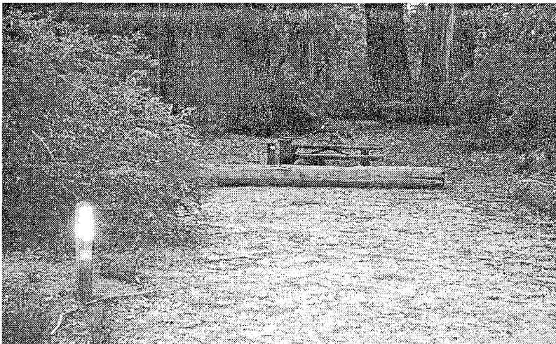
<그림 3-108> 오토캠핑장의 전기시설. 왼편 하단부의 조명시설에 전기 콘센트가 설치되어있다.
