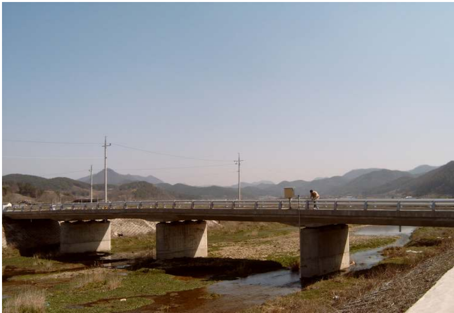
(그림 5-30) 동진강구역 상용교 지점 수위계 설치 전경
