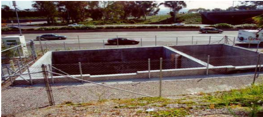
(그림 7-34) I-5/SR-78 오스틴 모래 필터 (Austin Sand Filter)
