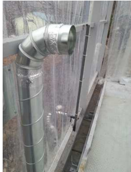
그림 2. 터널 내에 설치된 열풍기의 모습.
