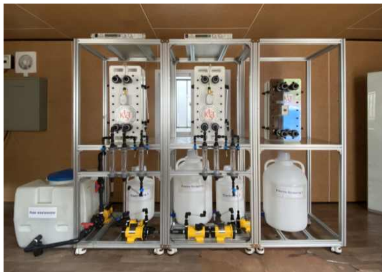
[그림 171] 현장에 설치된 암모니아 농축/회수 일체형 시스템의 모습
