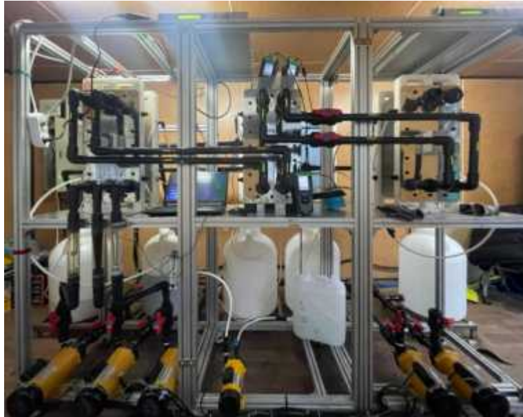
[그림 175] 1m 3 /day 규모 파일럿 플랜트 시스템 현장 설치 사진
