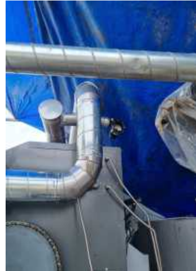
건조기 내부 습공기 강제배출 팬
