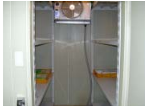
- 냉장 보관실 내부 사진
