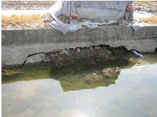
<그림 3-31> 수로의 노후화에 의한 측벽 파손
