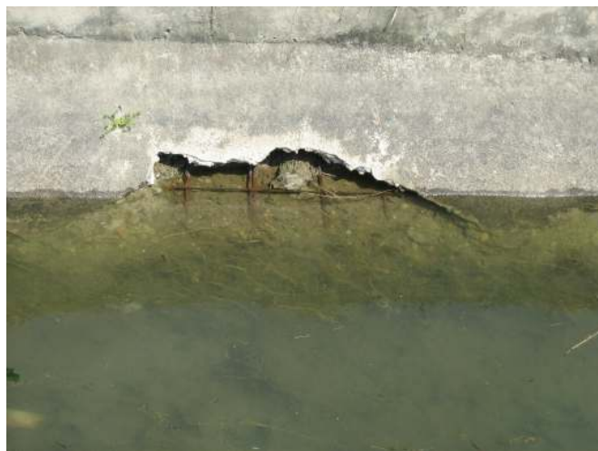
<그림 3-42> 계측 구조물 및 상·하류 수로의 노후화에 의한 파손
