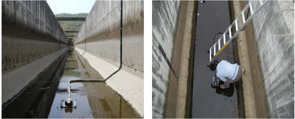
<그림 3-23> 용덕 간선 시점부 유량 계측기의 현장 설치
