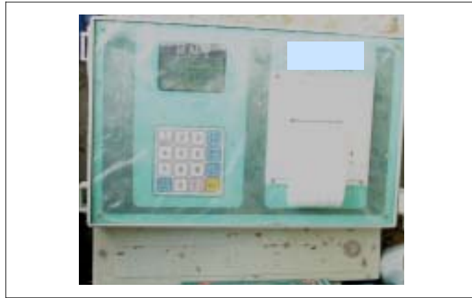
[그림3-62] 계사에 설치된 인디케이터
